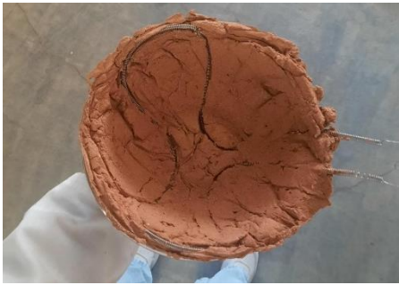
Ilustración 1. Vista superior de la base de resistencias colocadas con refractario.
